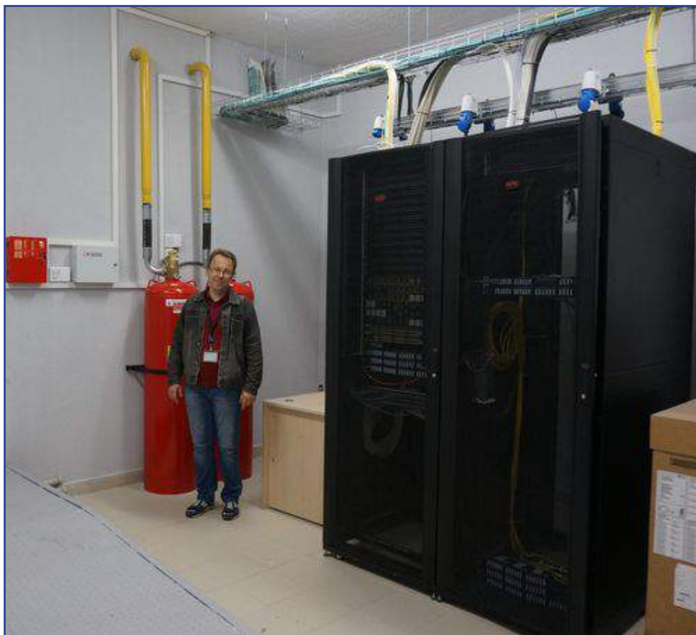
Сергей Романовец в тамбурной перед аппаратной нового ЦОДа. Сзади – баллоны газовой системы пожаротушения
