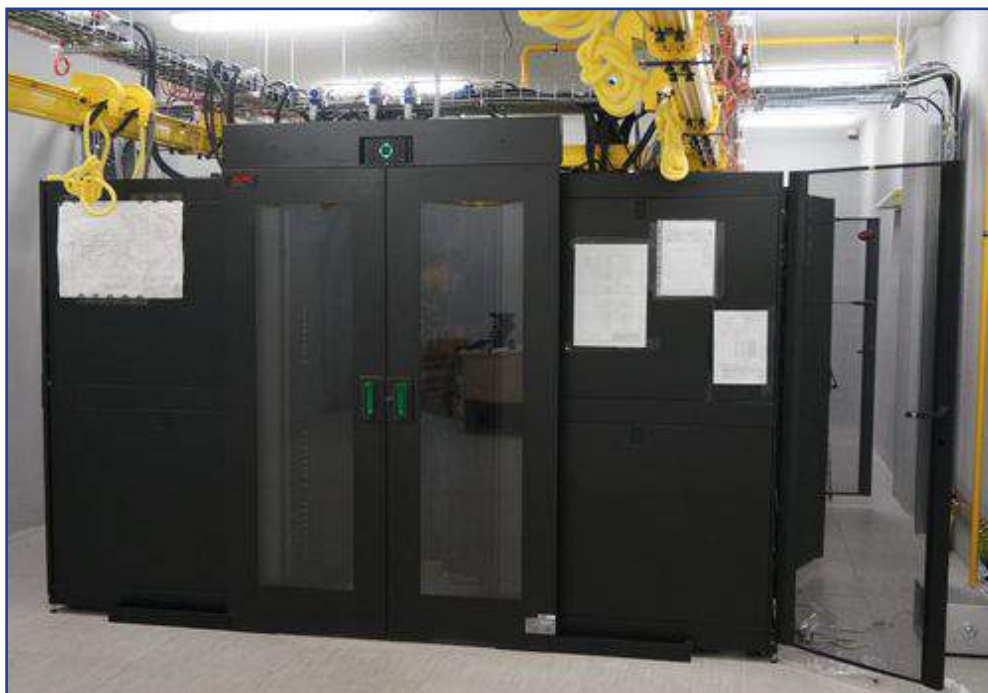
В ЦОД стоит новое коммутационное оборудование для локальной сети – в Белгазпромбанке такого раньше не использовали
